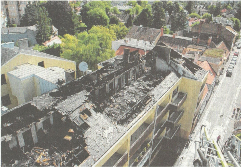
Trümmerhaufen nach Brand: Im Dachgeschoß des Wohnhauses waren die Lagerräume untergebracht
